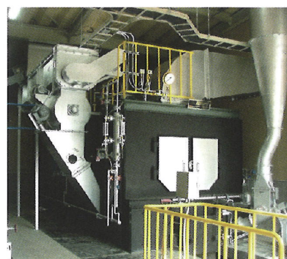
木屑焚きボイラー (3.3 t)
